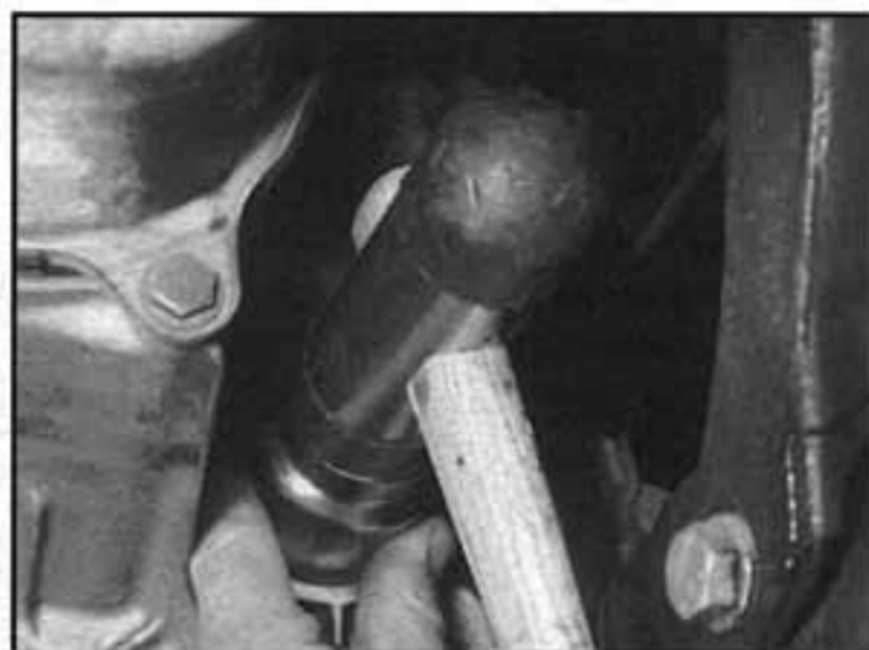
5.5 Namontujeme nové těsnění do jeho otvoru a pomocí trubkovitého trnu ho zaklepeme dovnitř
